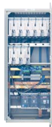
Baie 48V - 250A avec P2000
