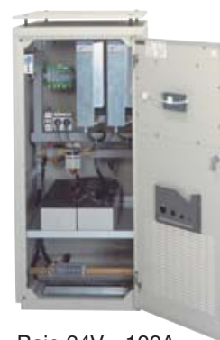
Baie 24V - 100A avec P2005
